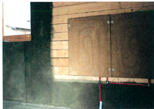
Lehm Klimatelemente als Wandheizung.
